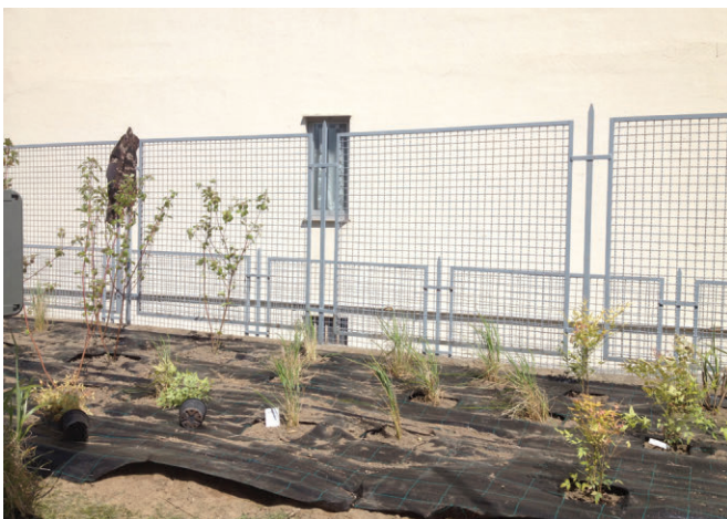
In alto a sinistra, e a destra: lo stato di fatto al 2017; in alto, e a destra: l'inizio dei lavori nella aiuole a maggio 2017, con la prima piantagione
